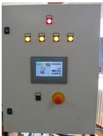
a- Ecranul HMI montat pe panoul de comandă și control
